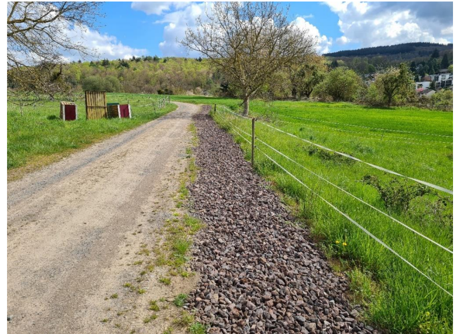
Foto: Straßenbegleitende Rigolen in Oberbieber, Quelle: BCE
