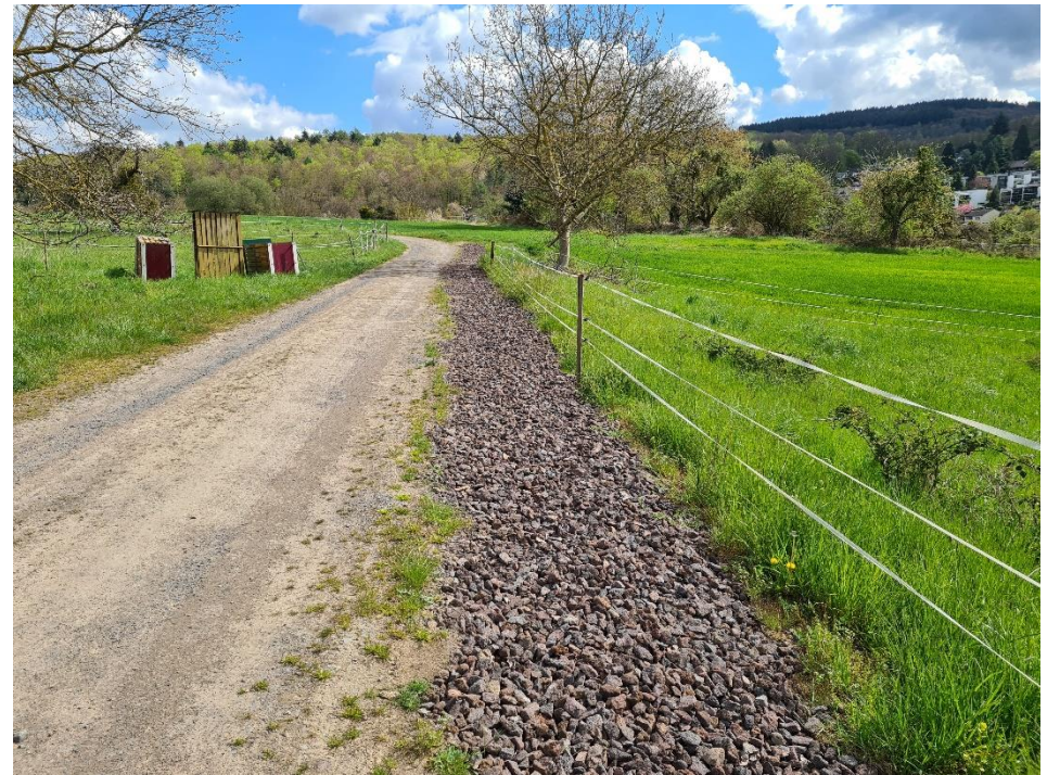
Foto: Straßenbegleitende Rigolen in Oberbieber, Quelle: BCE
